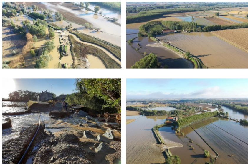
Figura 10. Riprese da drone dell'area danneggiata (fonte AiPO)
