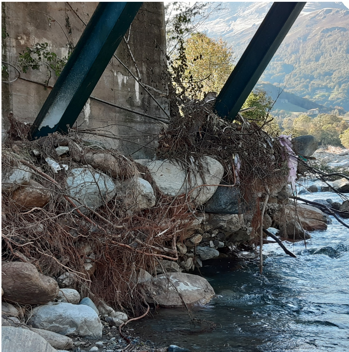
Figura 1. Erosione pila ponte Bailey
