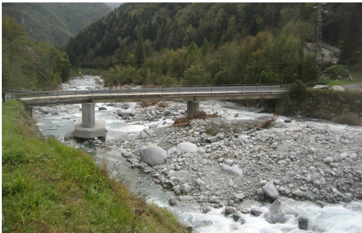
Figura 4. Erosioni pile accumulo materiale ponte torrente Soana località Crotto
