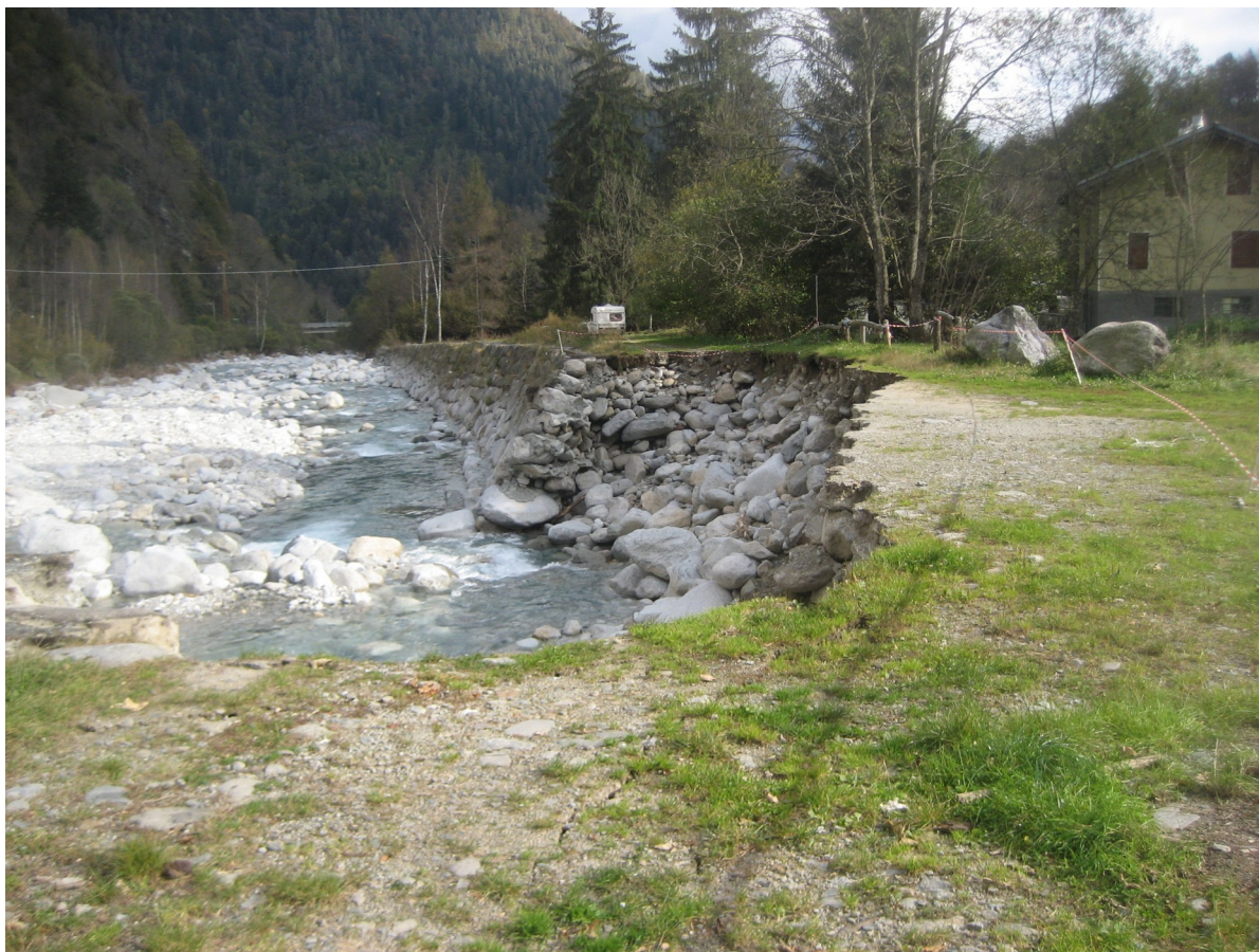
Figura 6. Erosione torrente Forzo località Convento
