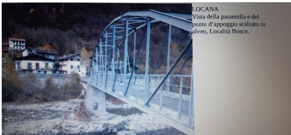
Figura 7. Scalzamento pila attraversamento torrente Orco in località Bosco
