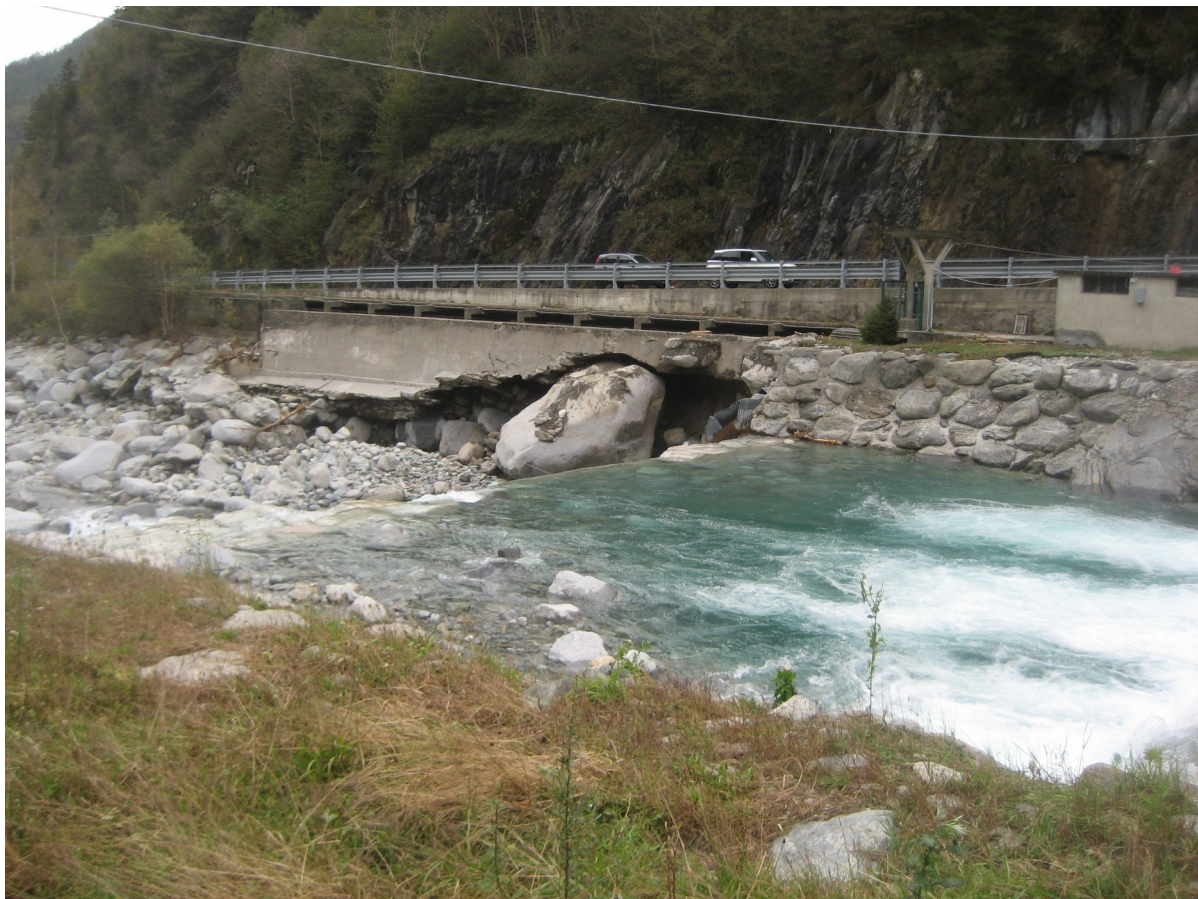
Figura 3. Erosioni spondali torrente Soana località Montelavecchia
