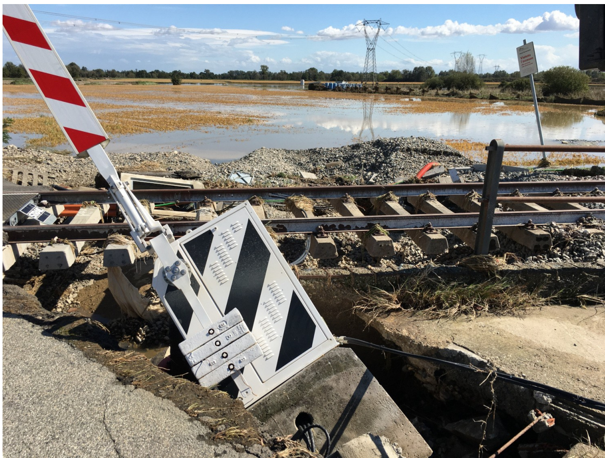
Figura 9. Danni alla ferrovia.
