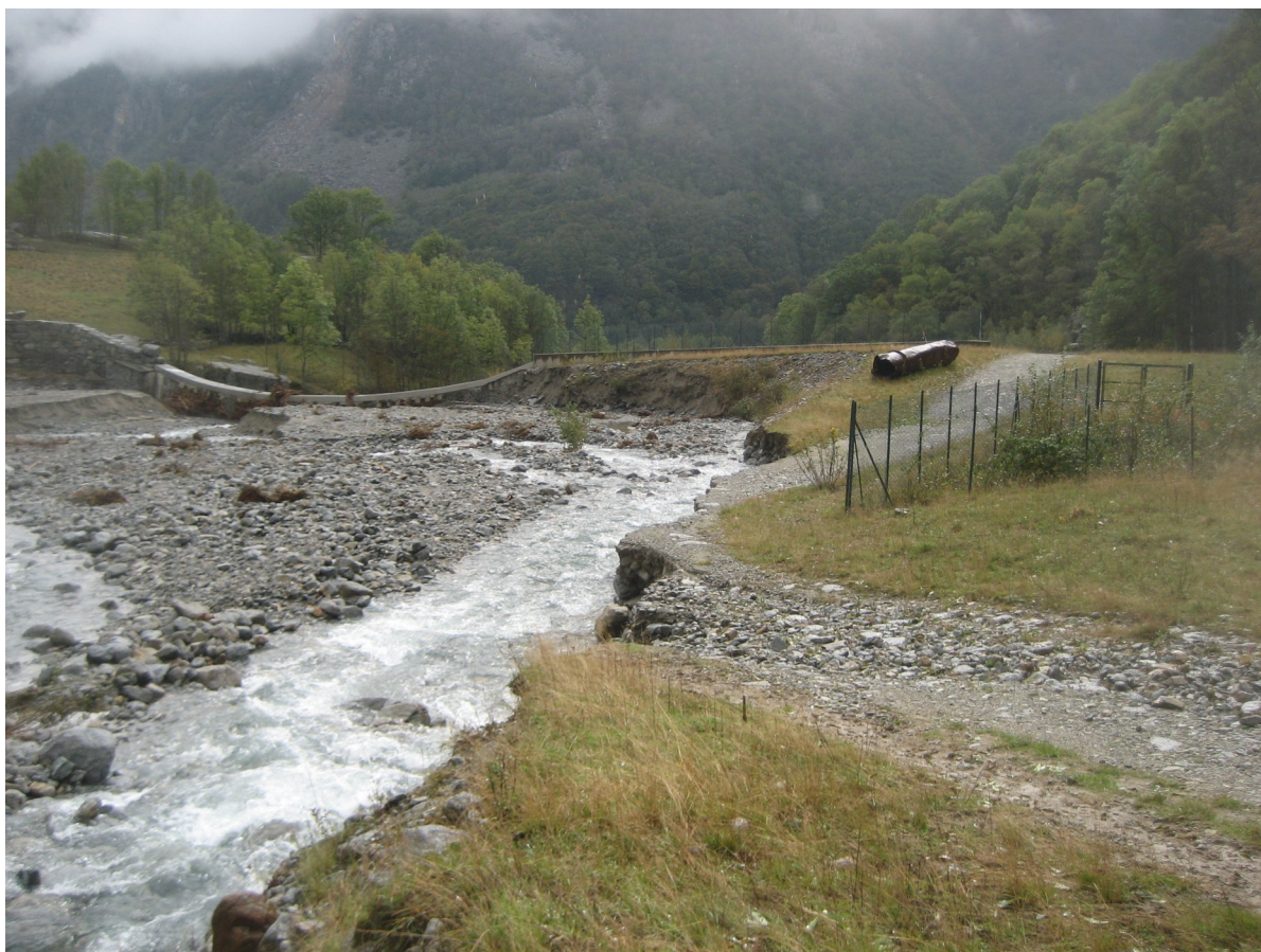
Figura 8. Accumulo materiale briglia selettiva e erosione spondale
