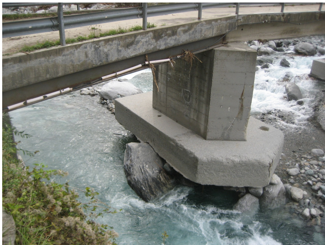
Figura 5. Erosioni erosioni pile ponte in località Crotto
